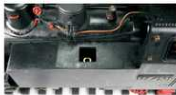
Wassernachspeiseventil im Wasserkasten.
